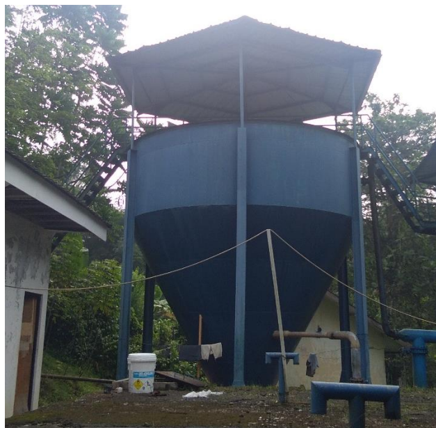
Gambar 13 Unit sedimentasi pada WTP Ciapus
